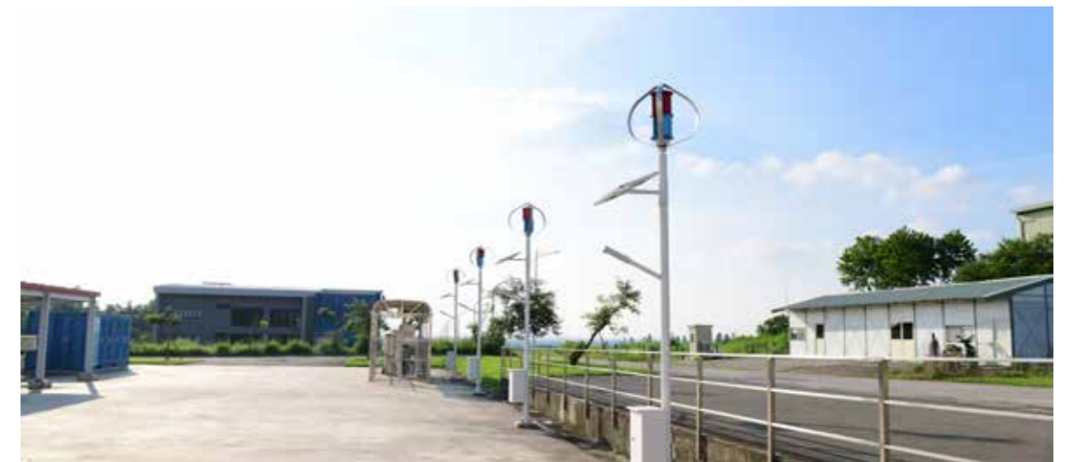
永續研發中心外側風力及太陽能發電路燈裝置
